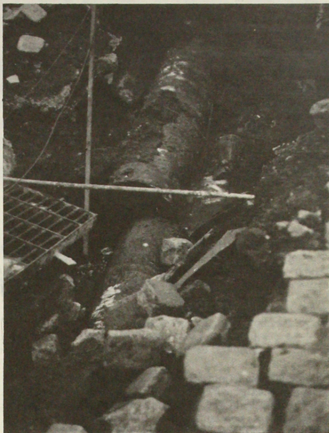
Fig. 4 Falla de líneas vitales en el puerto de San Antonio. La falla del suelo produjo la falla de este colector de alcantarillado.
